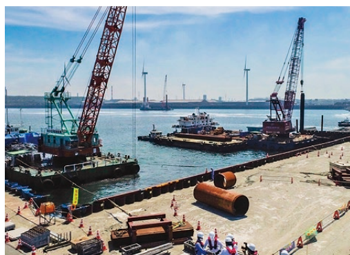
▲基地港湾として整備が進む鹿島港外港地区 写真提供：国土交通省関東地方整備局鹿島港湾・空港整備事務所
